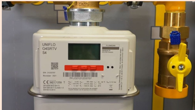
Nouveau compteur gaz digital
